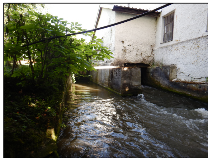
Bild 28 Absturz an Mühle nicht durchgängig
