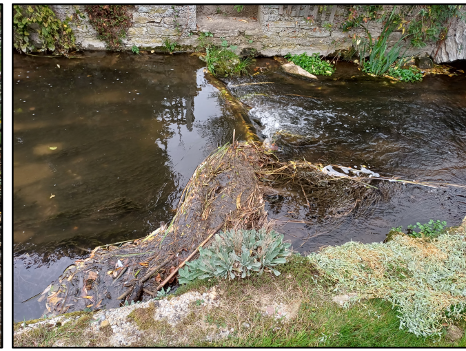
Bild 7 Sohlschwelle nicht durchgängig
