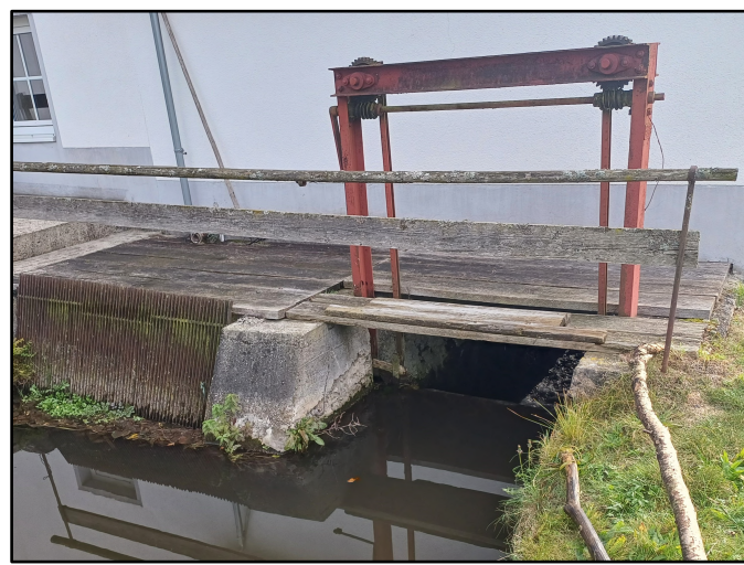
Bild 4 Absturz an Mühle nicht durchgängig
